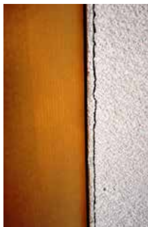
Crepe tra controtelaio e muro nella parte esterna.
