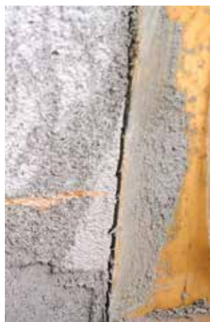
Crepe tra controtelaio e muro nella parte interna.
